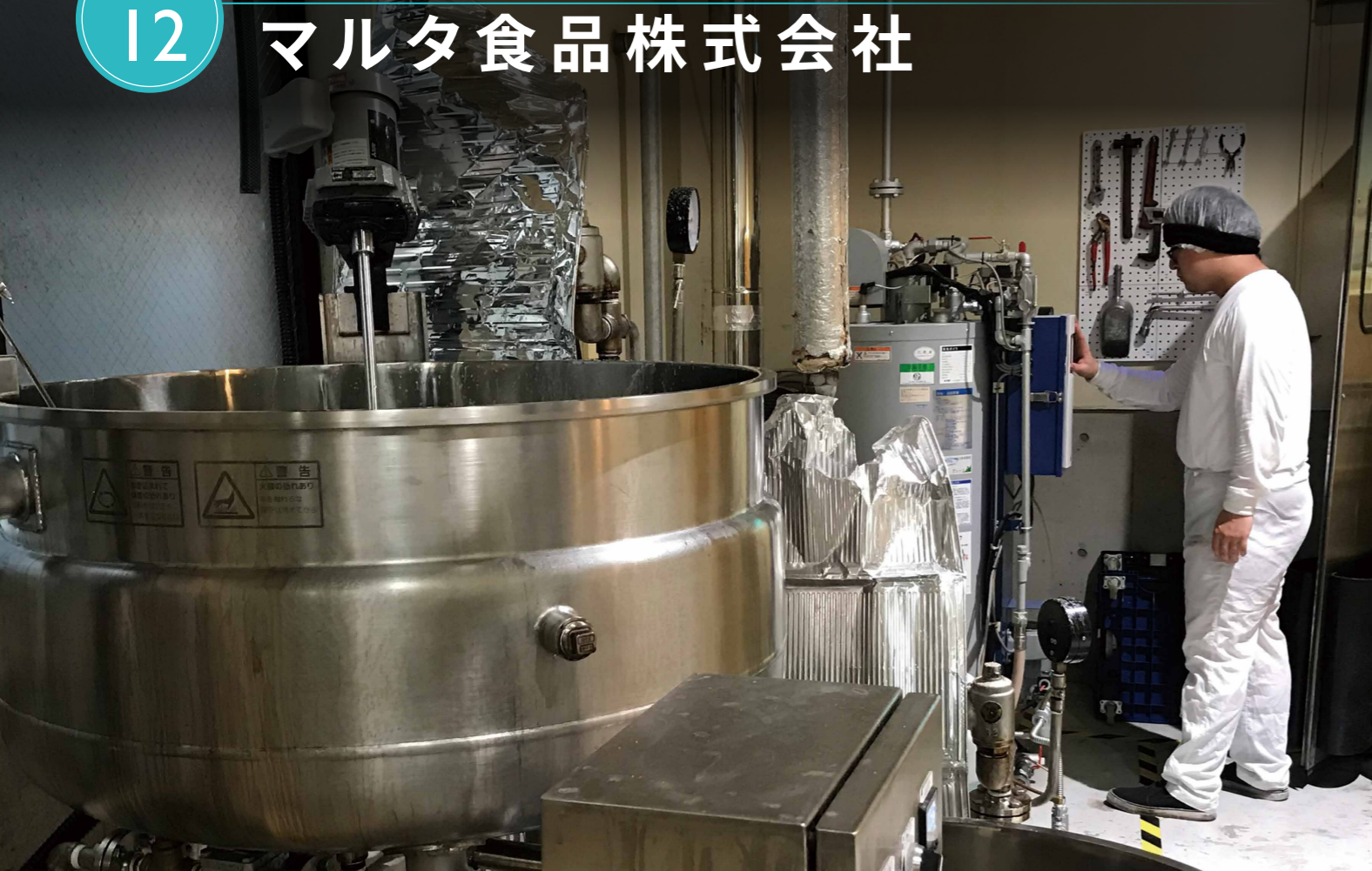
蒸気ボイラーの導入により温度の安定化とデータ化による安定生産を実現
