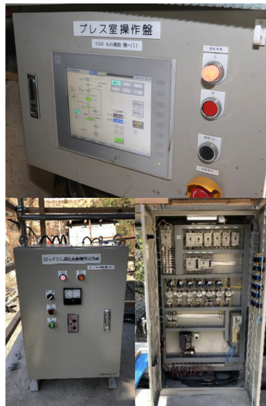
プラントに設置された制御盤は事務所で遠隔操作できる
