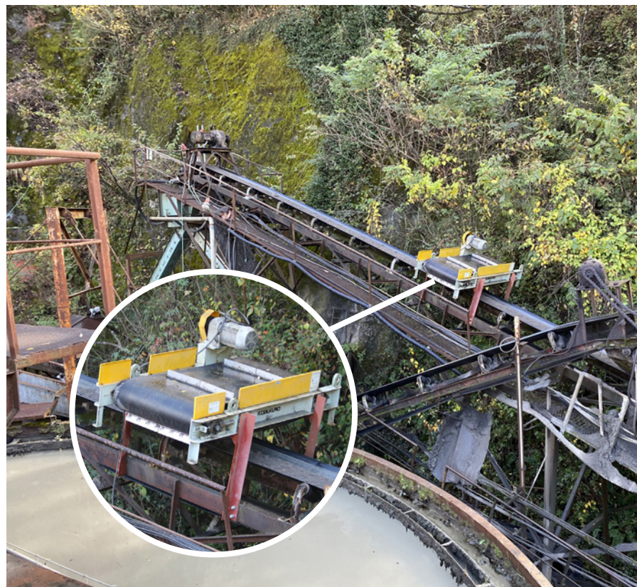
砕砂プラントに設置された永久磁石連続排出式の鉄片除去機
