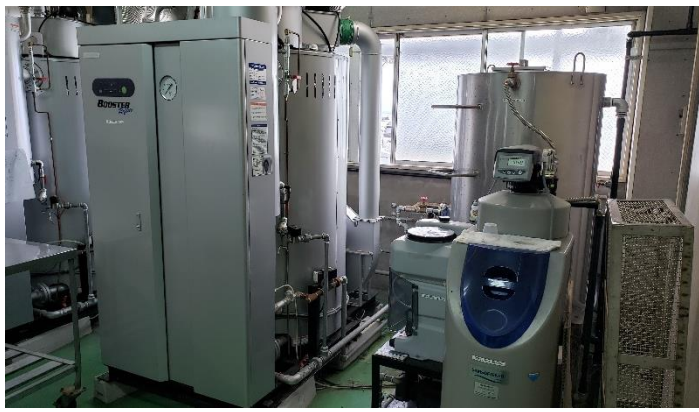
導入したボイラー装置
