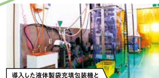
導入した液体製袋充填包装機とサーマルプリンタ
