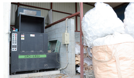
●左奥の設備が発泡スチロールの破砕・溶融施設
