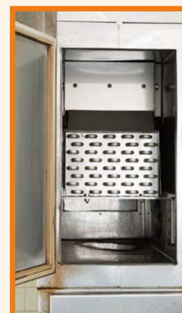
空調ユニット
