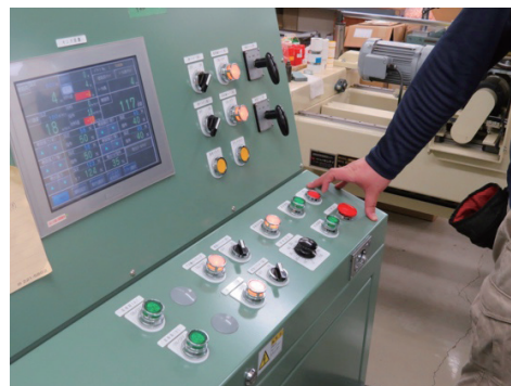
自動調節機能操作盤
