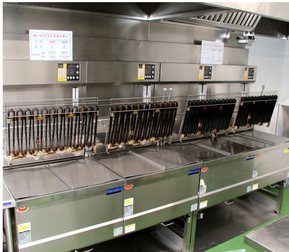
全自動化されたオートリフトフライヤー。従来は手作業で調理をしていた
