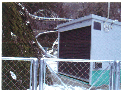
発電施設全景
