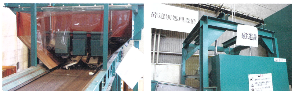
破碎された小型家電はベルトコンベアで運ばれた後、磁選機で鉄部分を選別する
