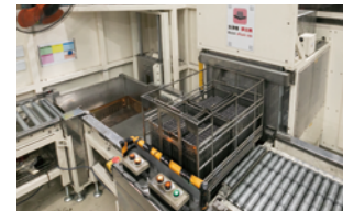
洗浄機機排出口
