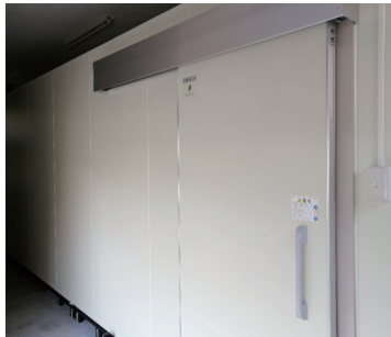
新設のプレハブ冷蔵庫
