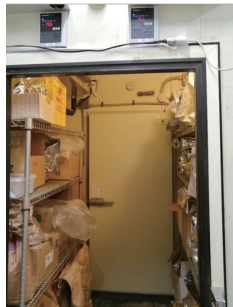
既設のプレハブ冷凍庫冷蔵庫
