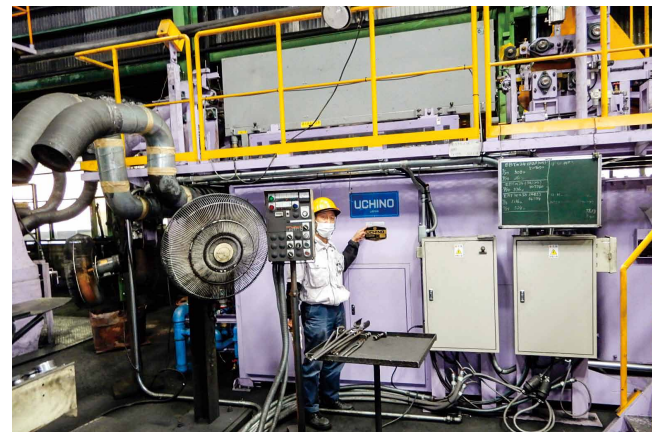
エアハンマーの能力に対応した加熱炉を導入
