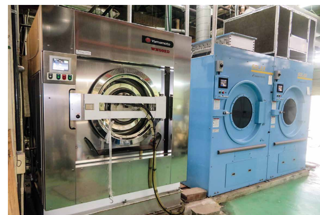
導入した水洗機(左)と乾燥機(右)
